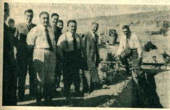
El Gobernador recorriendo las obras de tendido de cables para la provisión de aguas corrientes a la población.
