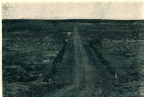
En la Ruta Nº 3 se han efectuado diversas obras de mejoramiento, especialmente dentro del perímetro comprendido entre Bahía del Fondo y Fitz Roy. La presente foto muestra el enripiado llevado a efecto hace poco tiempo.
